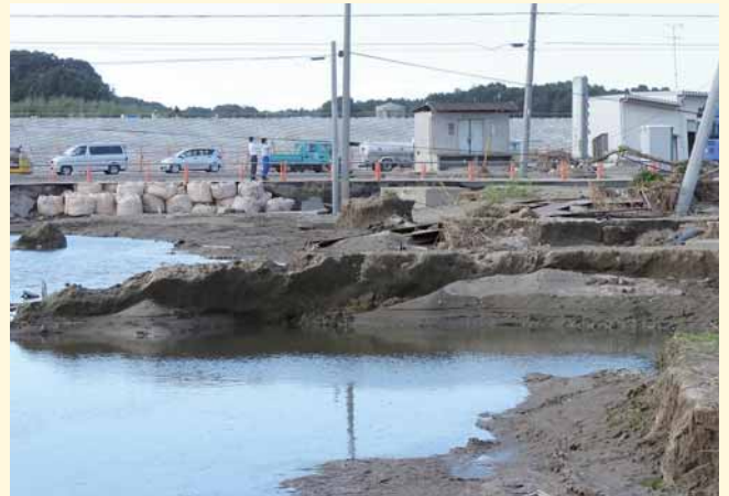
決壊現場付近（三坂町）
